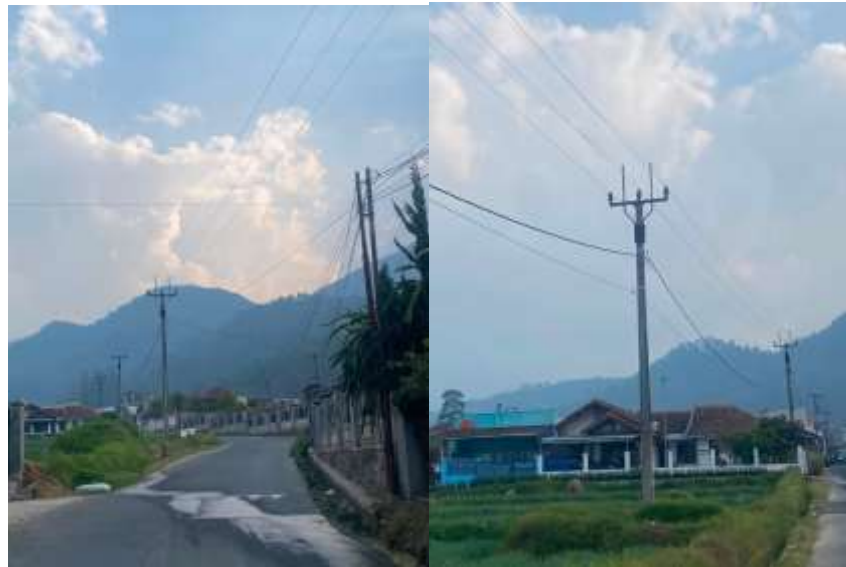
Gambar IV. 18 Tiang Listrik di Desa Lebakmuncang
