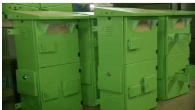
Gambar 4. 4 Box Panel Kwh Sumber : Dokumentasi Peneliti
