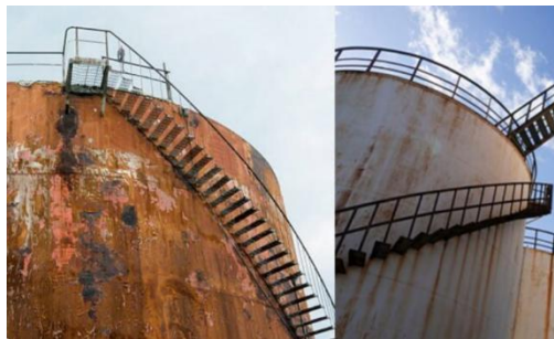
Gambar 8. Korosi pada tangki timbun ( storage tank ).
