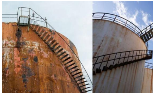
Gambar 3. Korosi pada tangki timbun ( storage tank )
