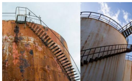
Gambar 6. Korosi pada tangka timbun ( storage tank )
