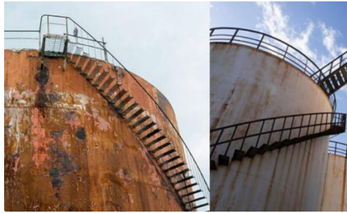
Gambar 8. Korosi pada tangki timbun ( storage tank )
