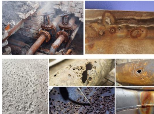
Gambar 4. Korosi pada pipa
