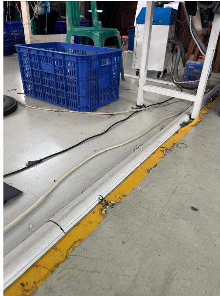
Gambar IV.3 Area Aliran Kabel Listrik
