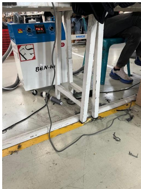
Gambar IV.4 Area Aliran Kabel Listrik
