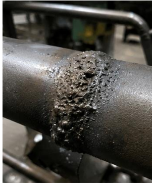
Gambar IV. 8 Defect Terdapat Porositas Berlebih ( Porosity )
