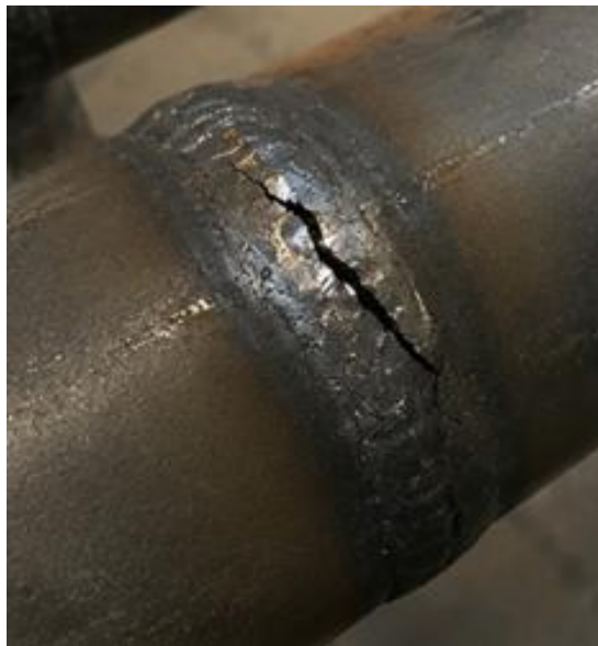
Defect Terdapat Retak (Crack)
