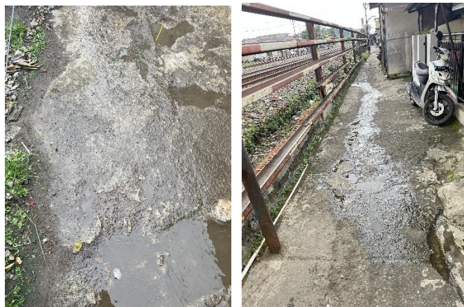
Gambar 4. 9 Kondisi Jalan Di Sempadan Rel Kereta RW 07
