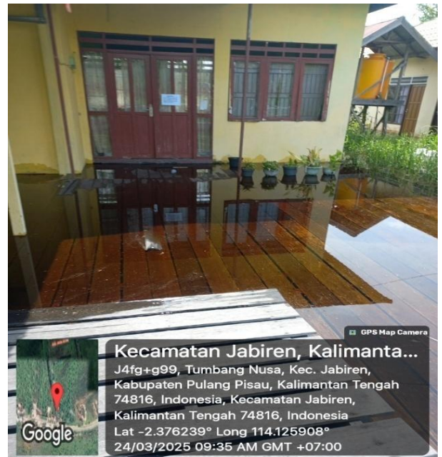
Gambar IV. 24 Kondisi Kantor Pemerintah Desa Terendam Banjir
