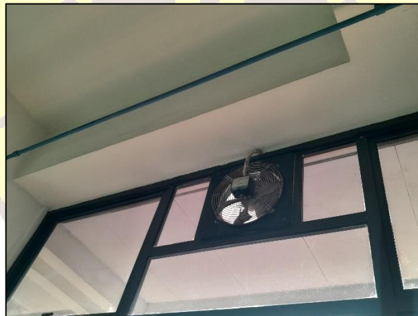
Gambar 17. Tersedianya Exhaust Fan pada Ruang Produksi
