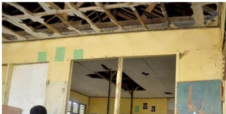
Salah satu bangunan Sekolah di Pandeglang yang rusak berat (dokumentasi peneliti, 2021)
