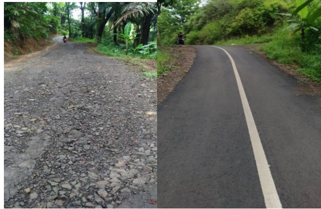
Gambar 5.6 Kondisi Jalan Menuju Kampung Kuta
