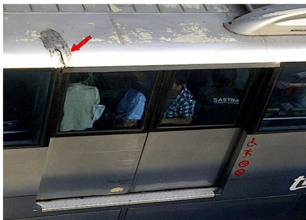
Gambar 2. Retakan pada atap di atas pilar pintu.
