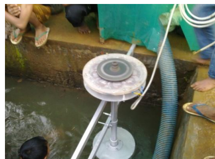
Gambar 2. Instalasi PLT- Mikrohidro, Palasari, Bogor
