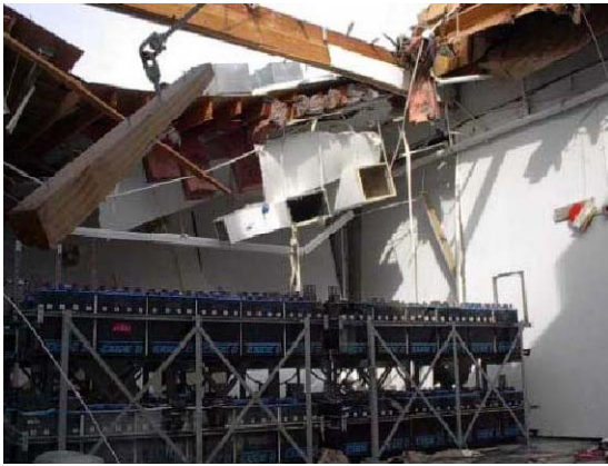
Gambar 2. Foto ruang baterai meledak
