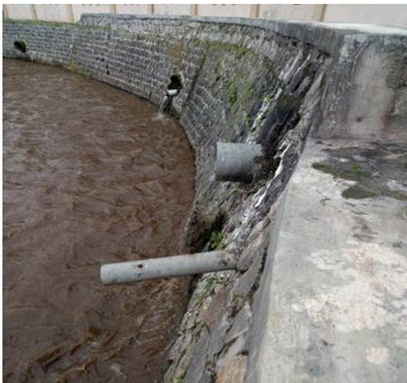
Gambar 10. Kondisi IPAL sAIIIG RW 1 dan 13 Cibabat
