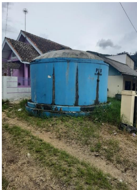
Bak Penampungan Air
