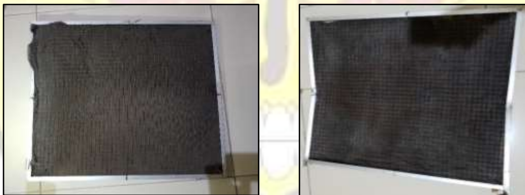
Gambar 4.14 Filter AC Sebelum (Kiri) dan Sesudah (Kanan) Pembersihan
