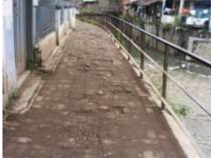
Gambar 3.7 Salah Satu Kondisi Jalan Kelurahan Nyengseret
