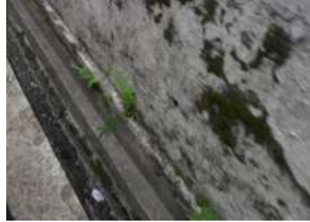
Gambar 3.8 Salah Satu Kondisi Drainase Kelurahan Nyengseret
