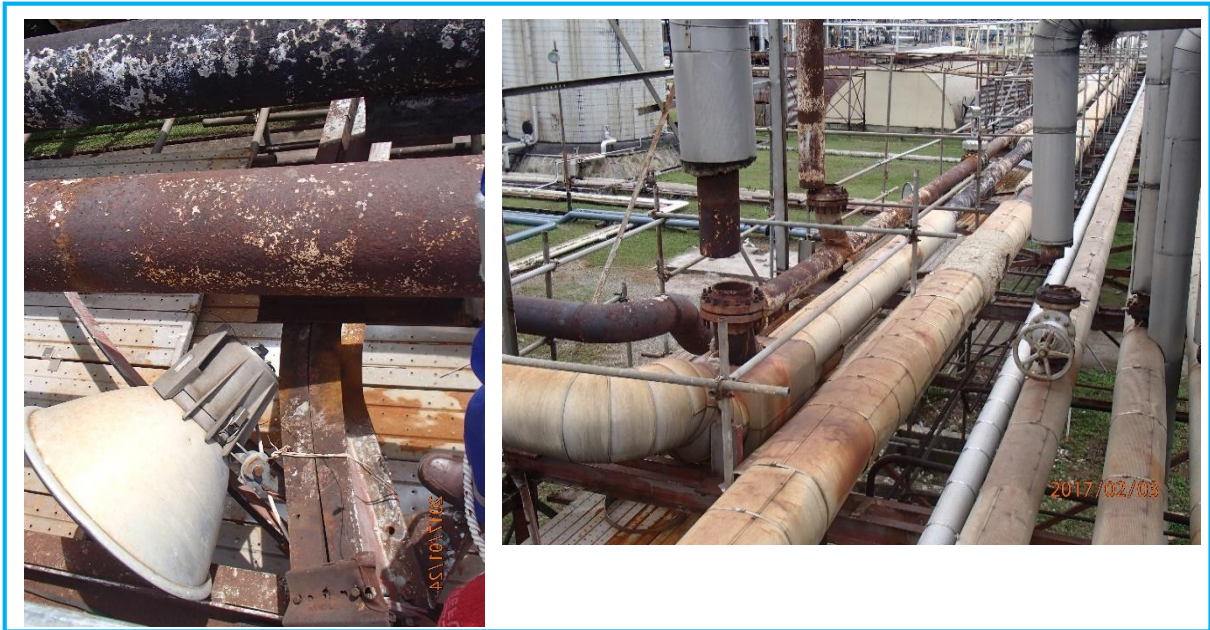
Gambar 1.3 Beberapa kerusakan yang terjadi pada jalur pipa steam 17 bar
