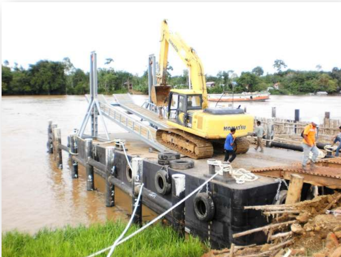
Gambar 1.1 Ramp Gate Door Penghubung Antara Dermaga ke Kapal Tongkang
